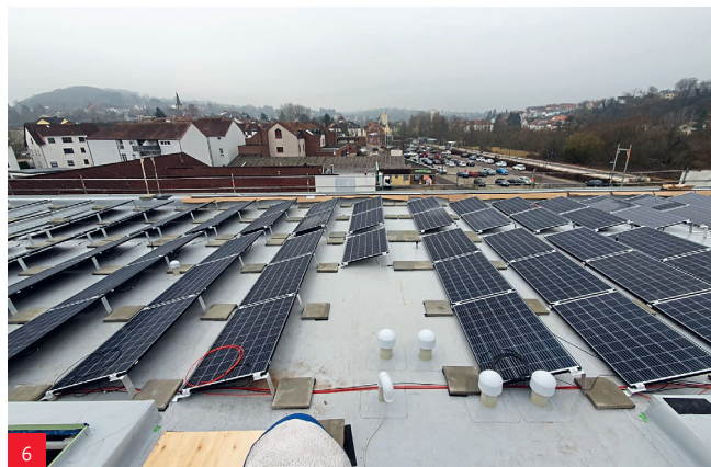
Die PVT-Wärmepumpenanlage in Eppelborn wurde im Dezember 2021 installiert und soll künftig durch ein begleitendes Monitoring überwacht werden.
